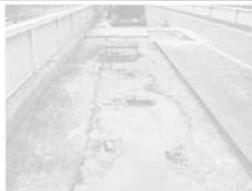
橋大橋の床版劣化
