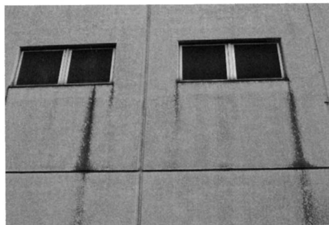
写真-2 開口部下端に認められる流水経路に起因する汚れ
