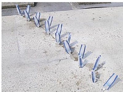
スラブ：ひび割れ
