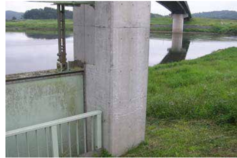
ひび割れ発生状況
