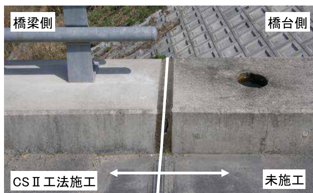
施工5年6ヶ月経過後状況
