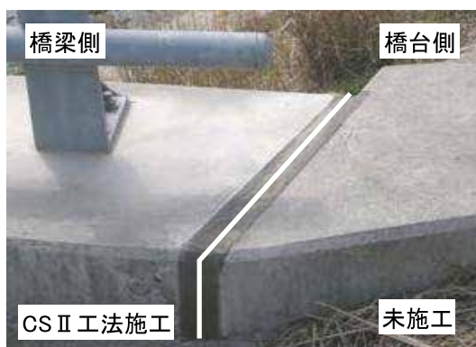
施工5年6ヶ月経過後状況
